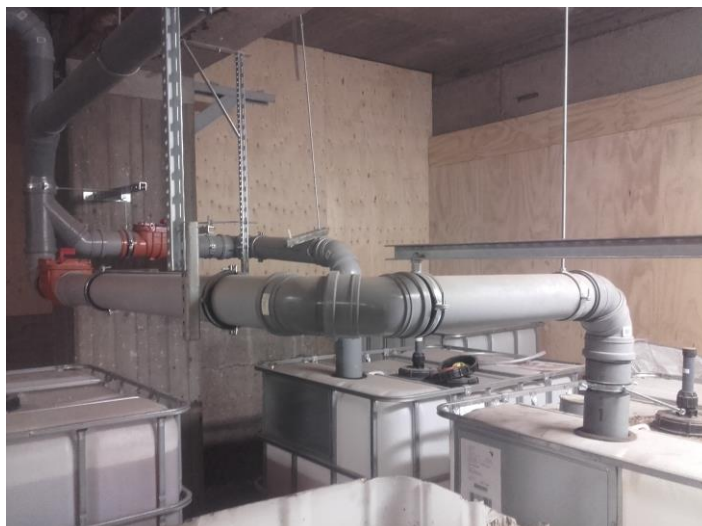
Figure 9 : Cuve de collecte à Tampere (Finlande) site de Kiivamo
