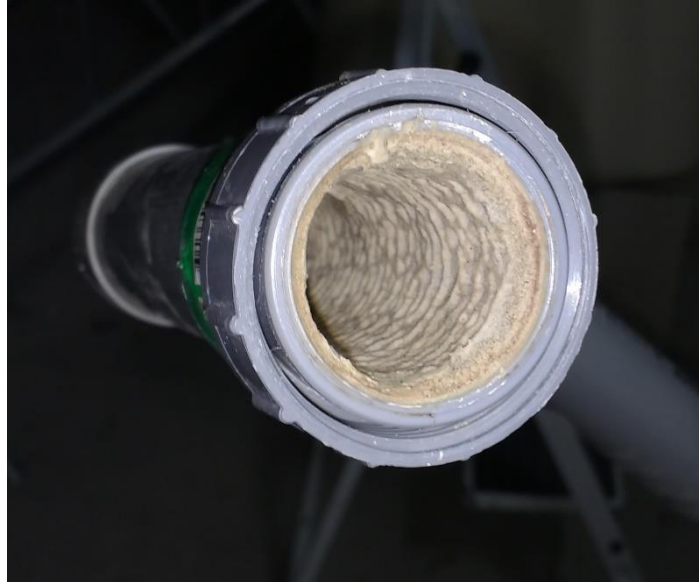
Figure 5 : Incrustation dans un PVC \varnothing 40 mm avec une pente de 4 % en deux ans de fonctionnement. Crédit : Tristan Martin.
