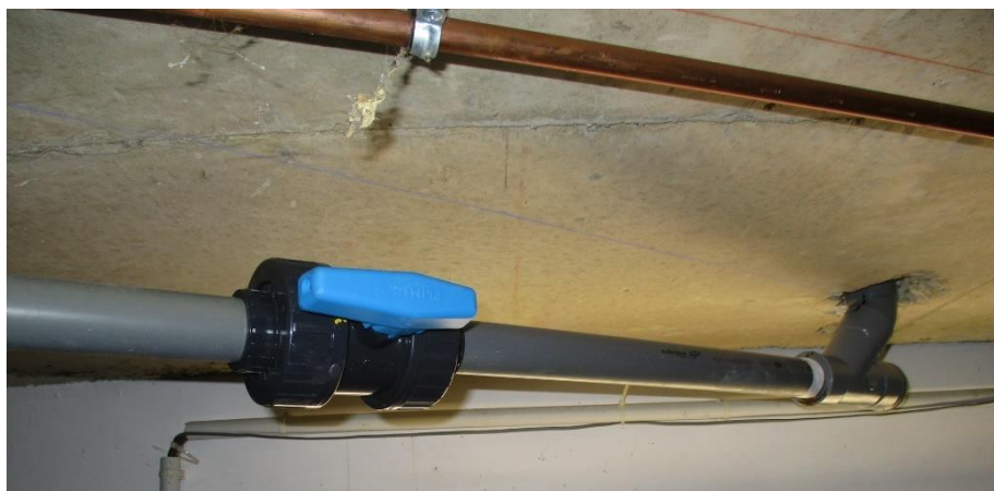
Figure 18 : Vanne à tourner pour la mise en charge d'une portion de réseau (PVC Ø 50 mm) avec du vinaigre blanc
