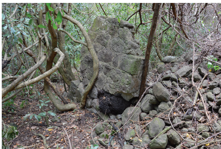
Figure 43 : bâtiment rectangulaire, mur disloqué.
