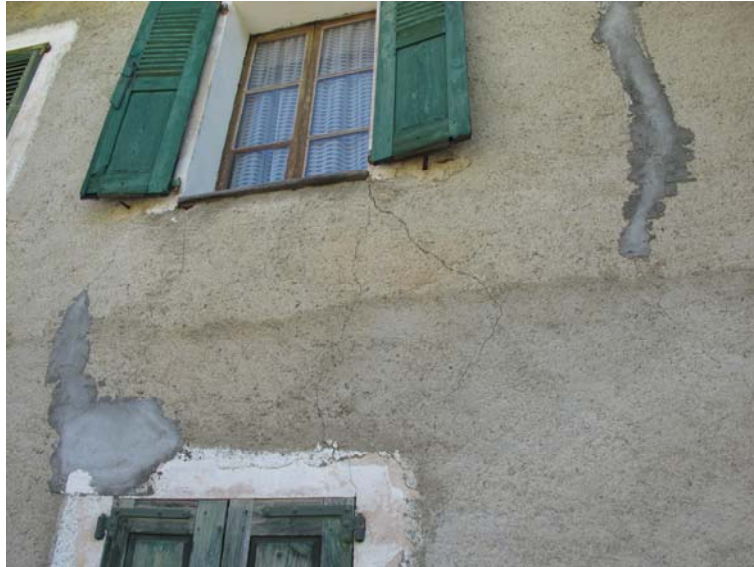
Photo M2 - Vue de la façade avec des fissures pré-existantes rebouchées et des fissures fines récentes.
