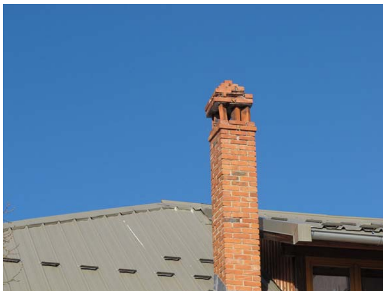
Photo FB1 - Chapeau de cheminée déséquilibré (centre de Faucon-de-Barcelonnette) (BCSF).
