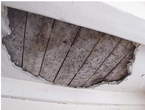
Photo B12 - Chute de partie importante de plâtre (habitation vulnérabilité A, centre historique).
