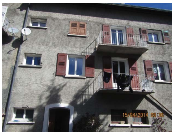
Photo C2 - bâtiment de vulnérabilité A, route de Sainte-Anne, fissures fines non traversantes dans les coins intérieurs du bâtiment et au plafond du 2eme étage.
