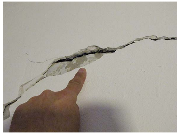
Photo B13 fissure sur le haut d'une porte sans traverse (habitation vulnérabilité A, centre historique).
