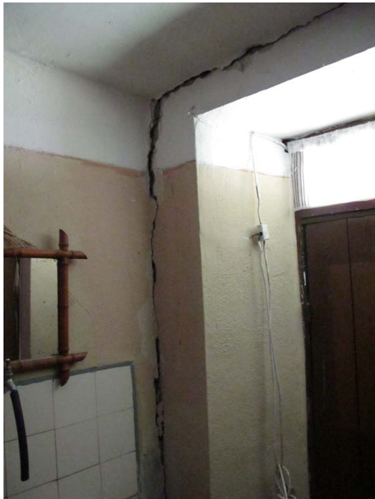
Photo M3 - Fissures avec ouverture centimétrique à la liaison mur intérieur/extérieur ou dalle/mur extérieur.
