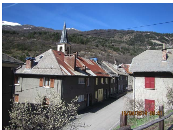
Photo C1 - cheminées tombées et sécurisées (centre du village)
