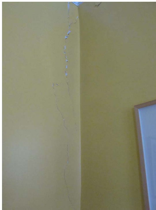
Photo B1 - Fissure (longueur métrique, ampleur millimétrique) à l'angle d'un mur porteur, Villa mexicaine (Musée = Villa la Sapinière). Exemple de dégât cumulé. La fissure de droite est due au séisme de février 2012, celle de gauche au séisme d'avril 2014.
