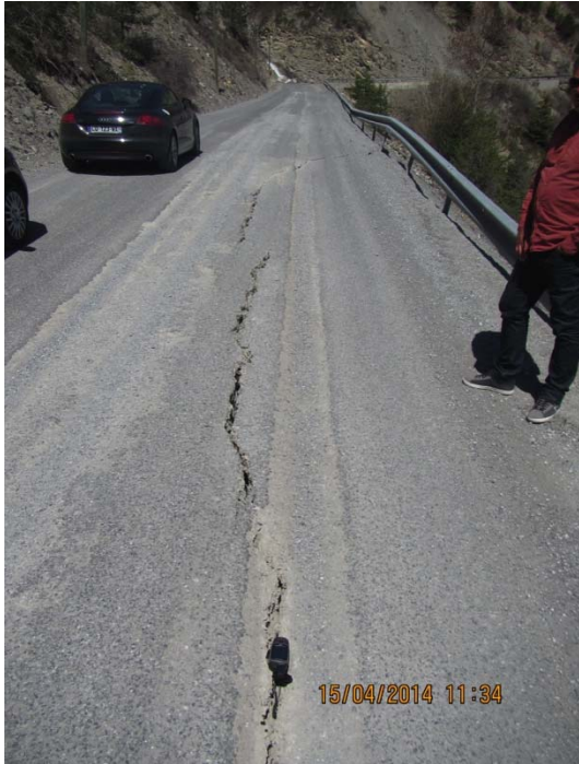
Photo C11 - Tassement de la partie droite de la chaussée avec ouverture du revêtement supérieur sur la route de Sainte-Anne. (préexistence possible).
