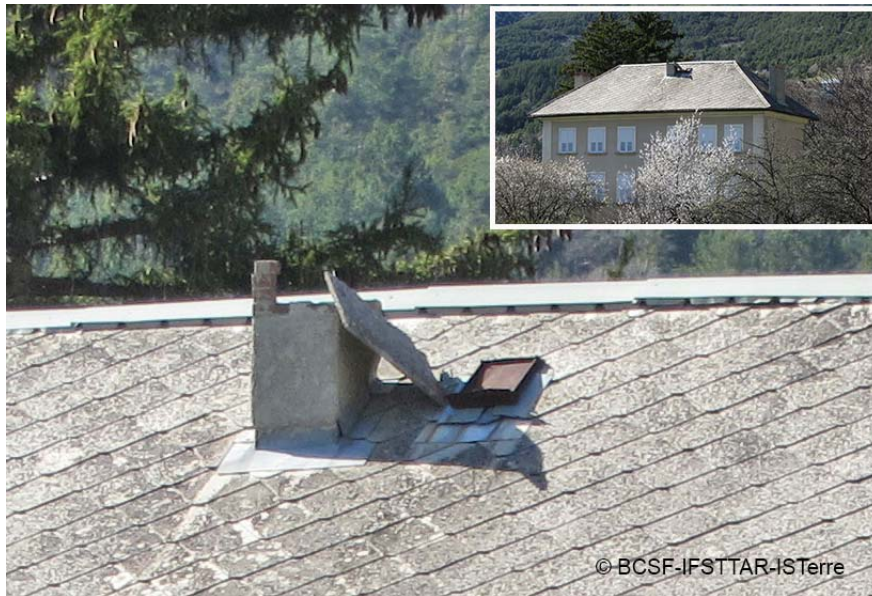
Photo J1 – Chute du chapeau de cheminée
