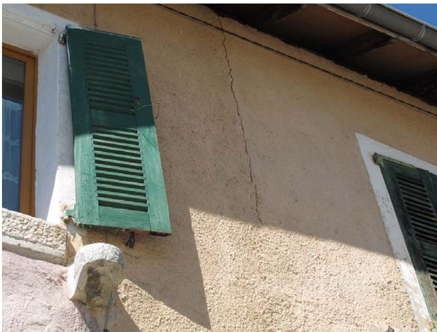
Photo M2 - Fissure fine dans la partie haute du bâtiment.
