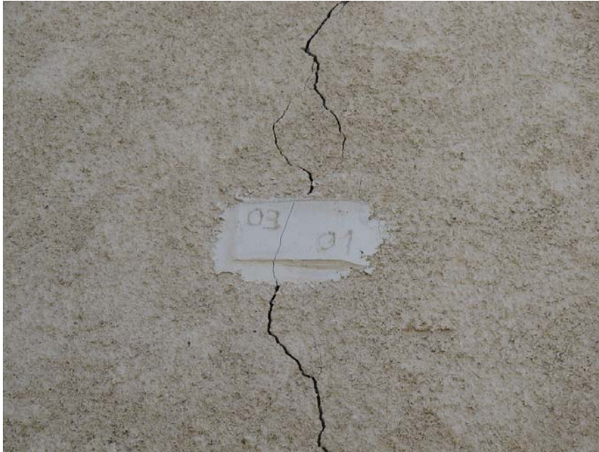
Photo M1 - Fissure pré existante sur front de l'église avec plot de contrôle (Mars 2001) reprise par une fissure fine d'ampleur millimétrique (fissure dans le plot).
