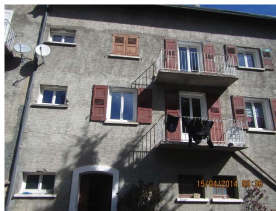
Photo C2 - bâtiment de vulnérabilité A, route de Sainte-Anne, fissures fines non traversantes dans les coins intérieurs du bâtiment et au plafond du 2eme étage.
