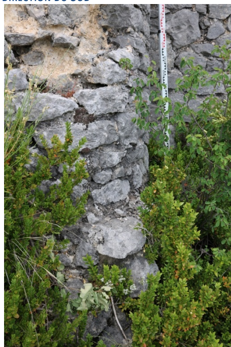
FIGURE 19 – SECTEUR 2 - MASSIF MAÇONNÉ AU PIED DU CONTREFORT
