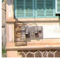
Appareil de comptage
