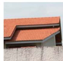
Décroché de toiture
