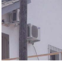
Appareil de climatisation
