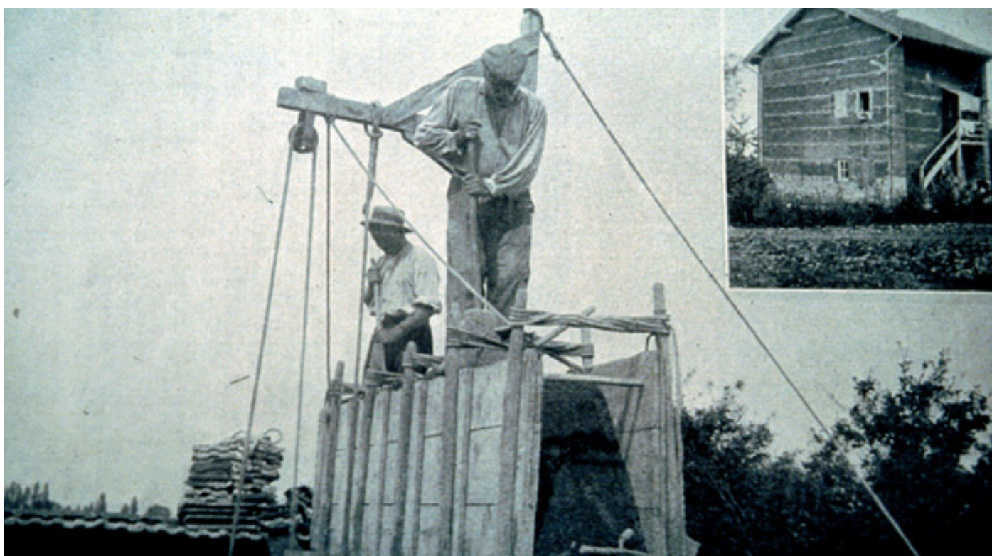
Maçons piseurs à l'oeuvre entre les banches, technique traditionnelle de construction en pisé de terre.
