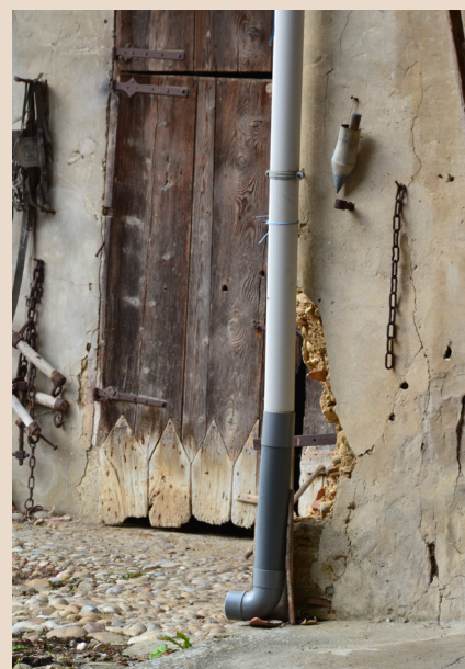
Le défaut d'entretien notamment autour des systèmes d'eau peut rapidement occasionner des dommages structurels.
