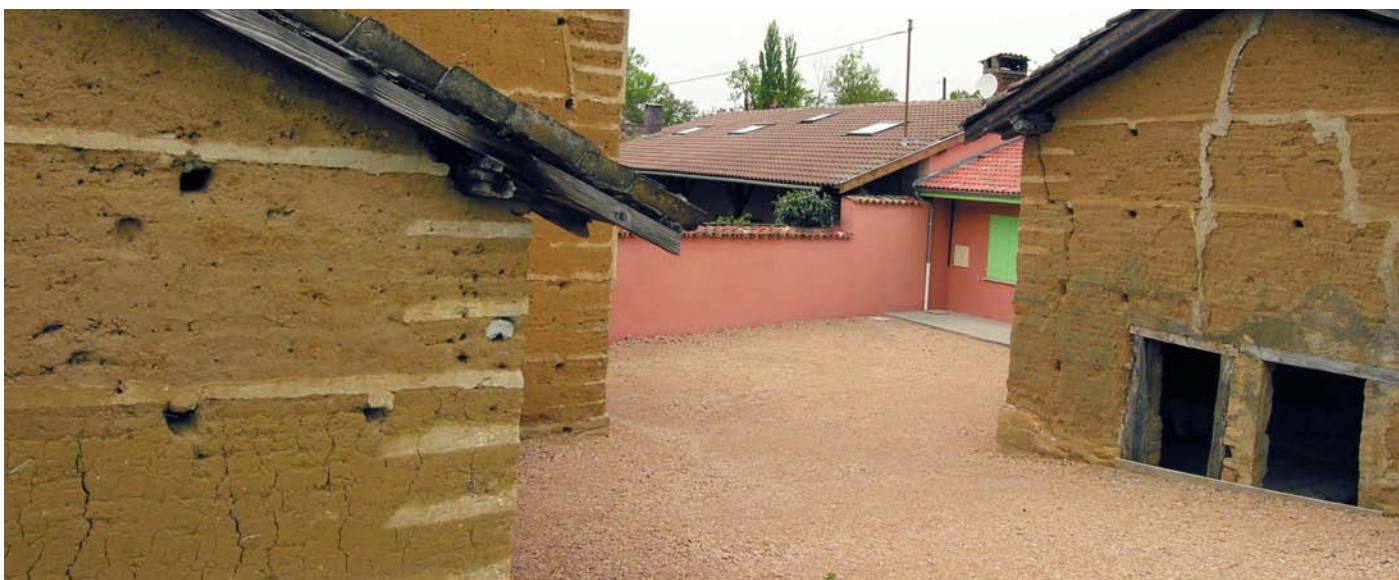
Les structures en pisé sont sensibles aux aménagements réalisés à leurs abords directs puisque ces derniers changent le comportement des sols et notamment de l'eau qu'ils contiennent. Un bâtiment en pisé voyant son soubassement enterré sera systématiquement victime de pathologies liées aux remontées capillaires.
