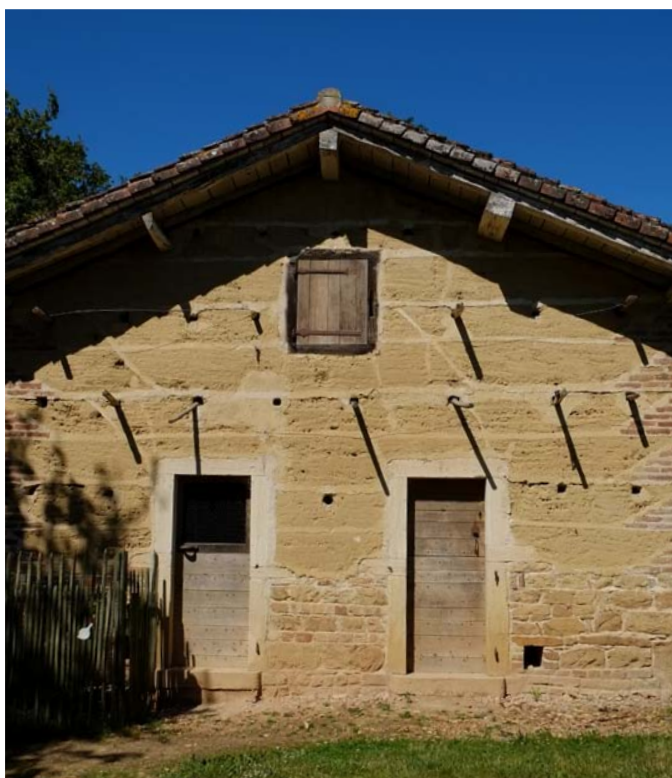
Utilisation du pisé sur soubassement en pierre et chaînage d'angle en briques cuites.
