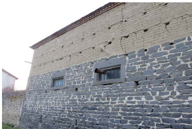
Élévation en pisé avec cordons de chaux réguliers et joints obliques, sur un premier étage élevé en pierres noires.
