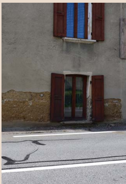
Les réductions de soubassement occasionnées par des aménagements aux abords du bâti sont la première cause de sinistres.
