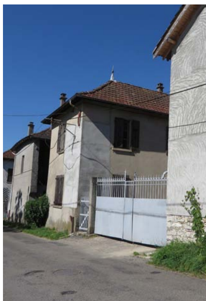
Les travaux de ravalement sont rarement adaptés au support pisé (enduits ciments et grillages non conformes aux règles professionnelles).
