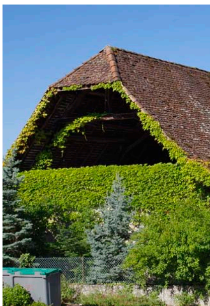
Un manque d'entretien peut masquer des dommages fragilisant rapidement les structures.
