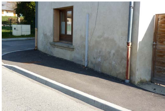
Le traitement des voiries est très fréquemment source de désordres graves pour les édifices en pisé.
