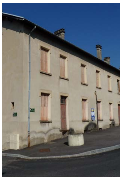
Les rehausses étanches diminuent les hauteurs de soubassement et fragilisent les structures en pisé par l'action des remontées capillaires.
