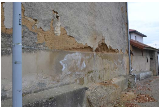
Ce désordre menace les usagers du bâti mais également ceux du domaine public. Un technicien avisé pourrait le détecter et ainsi prévenir des risques.
