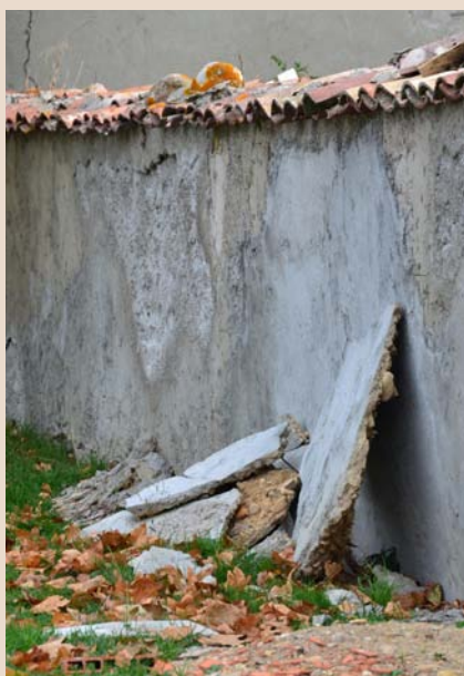
L'application d'enduits non adaptés (ciment) favorise l'accumulation d'humidité dans le mur et participe à sa déstructuration.
