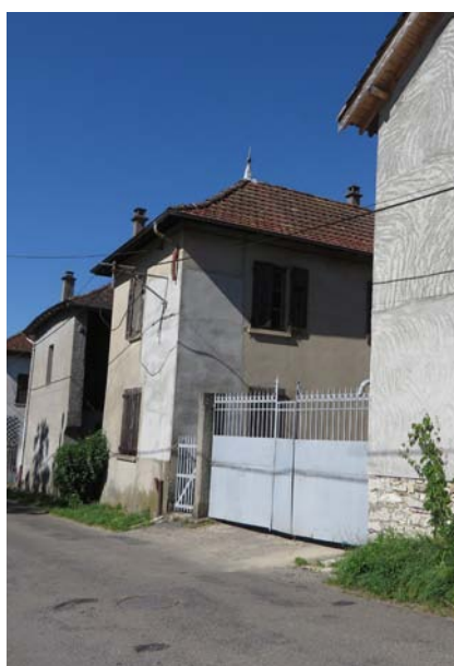
Les travaux de ravalement sont rarement adaptés au support pisé (enduits ciments et grillages non conformes aux règles professionnelles).
