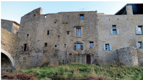
Figure 5 : ancienne muraille de la ville percée lors de son aliénation par les propriétaires des maisons contiguës. Photo J. Foltran.
