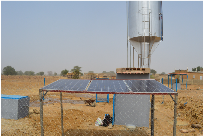
Fig. 1. Photo de l'installation
