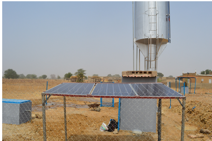
Fig. 1. Photo de l'installation
