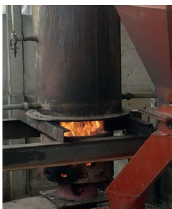
Figure 4 : Brûleur des gaz de pyrolyse en fonctionnement
