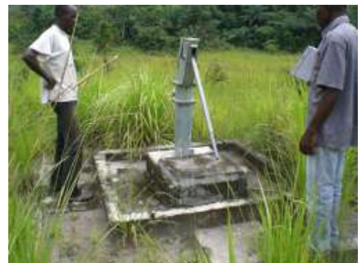
Photo 40 : Pompe endommagée à Djouengué.
