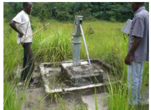
Photo 40 : Pompe endommagée à Djouengué.
