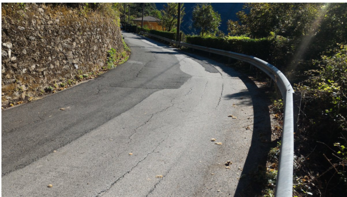
Figura 9: strada adiacente alle case, la fotografia rappresenta lo stato dei luoghi in data 3 ottobre 2018.
