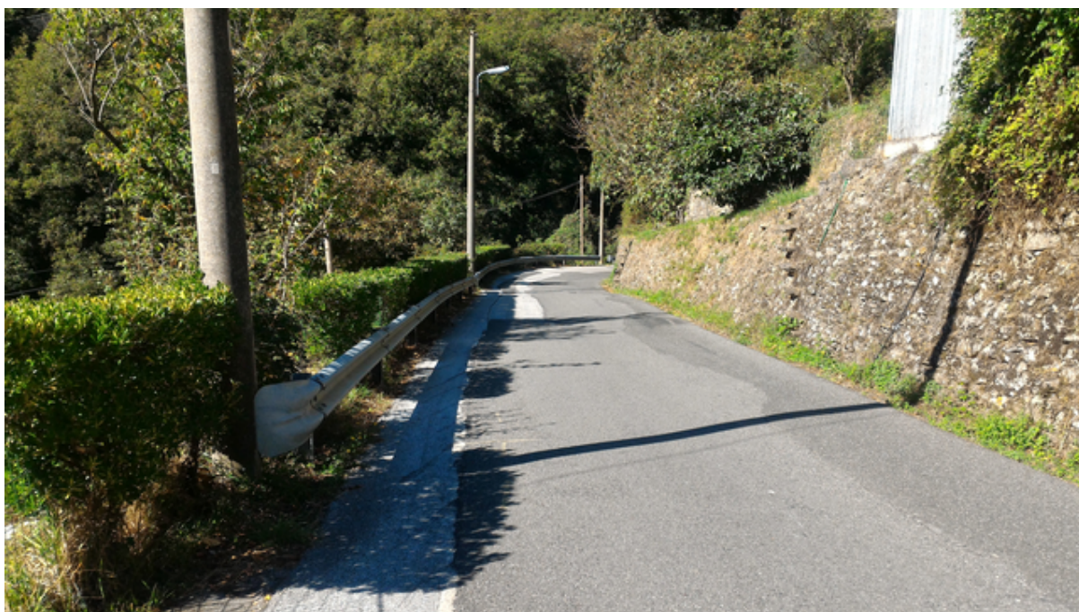
Figura 11: strada adiacente alle case, la fotografia rappresenta lo stato dei luoghi in data 3 ottobre 2018.
