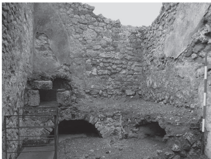
Fig. 136 – Table à feu disposant d'un petit four maçonné dans la Casa delle Suonatrici (IX 3, 5.24) à Pompéi (cliché : P. Kastenmeier, Deutsches Archäologisches Institut).
