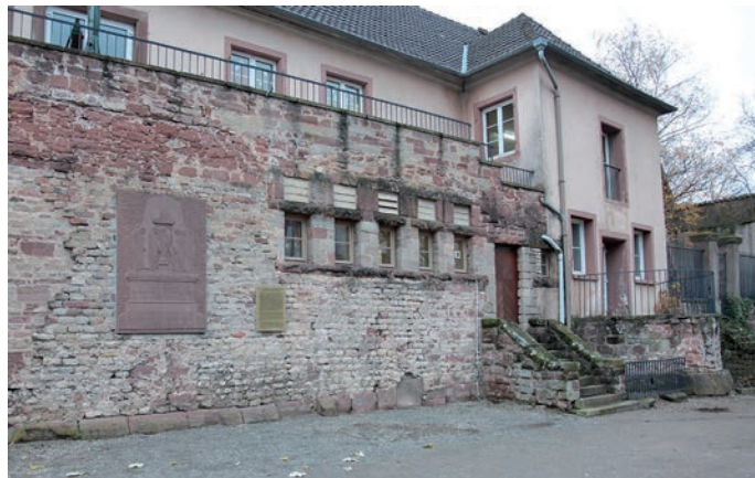
Fig. 7 – Détail de l'élévation de la courtine de l'enceinte tardive à Tabernis-Tres Tabernae (cliché : N. Meyer, Inrap).
