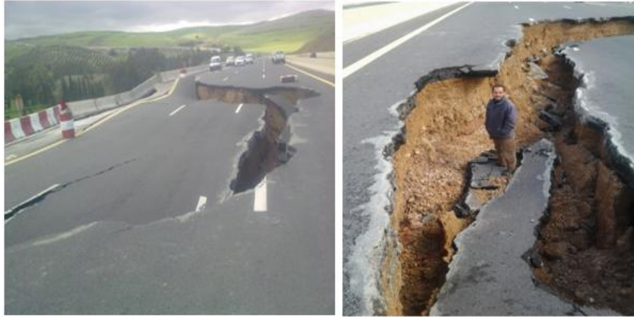
Figure 1. Déformation du corps de chaussée.
