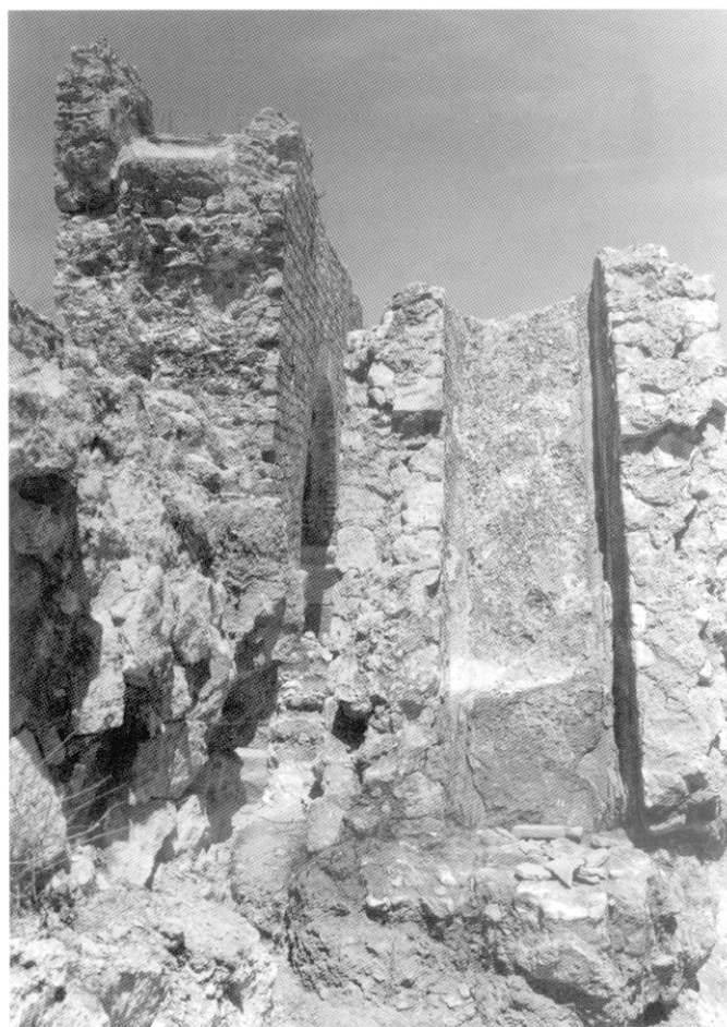
→ Fig. 94 – Le specus du pont-aqueduc de Barbegal à Fontvieille : section basculée par effondrement de la dernière arche (B27/culée aval) (cliché P. Foliot, CNRS).
