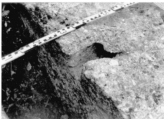
Fig. 55 – Trou de logement de crampon de bois reliant deux blocs de grand appareil de la culée amont du pont de Font Ménéstière. La cavité était recouverte par un opercule de mortier de chaux qui portait, en négatif, les traces du sciage du crampon de bois (cliché J.-L. Paillet, CNRS).
