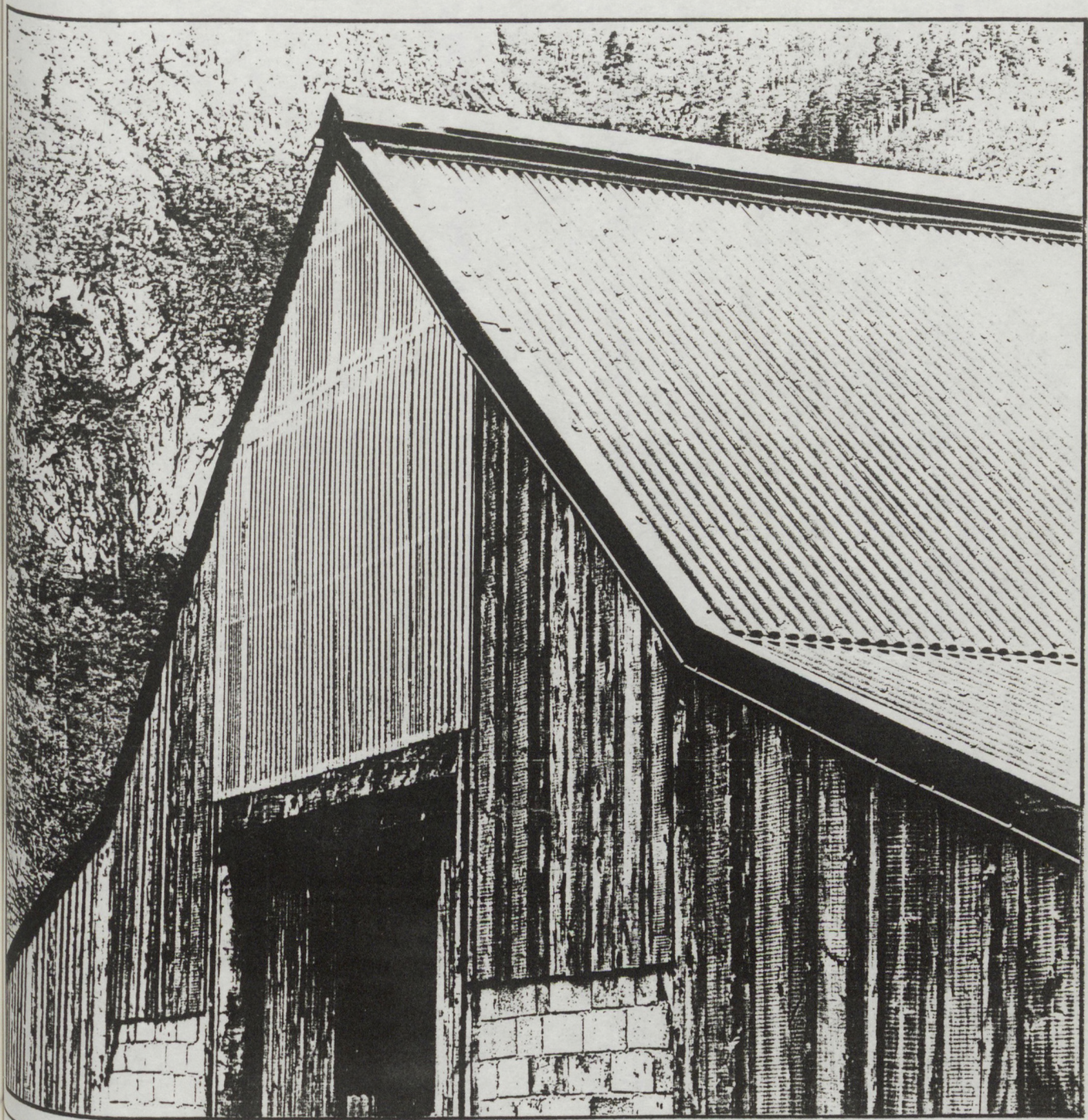
INFLEXION DE LA TOITURE ET FAITIERE VENTILEE.
