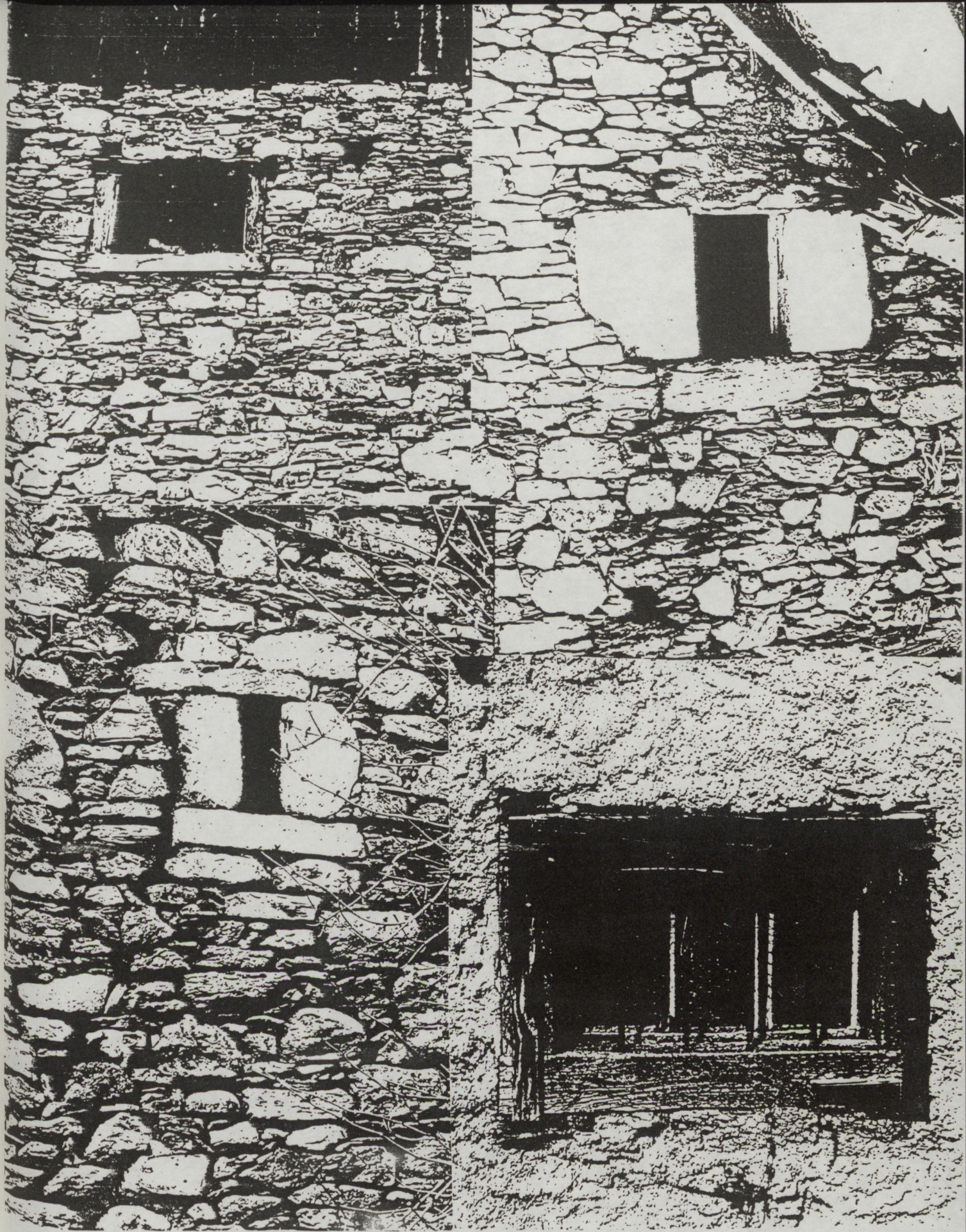
... DES BATIMENTS VETUSTES, MAL ECLAIRES ET MAL AERES...
