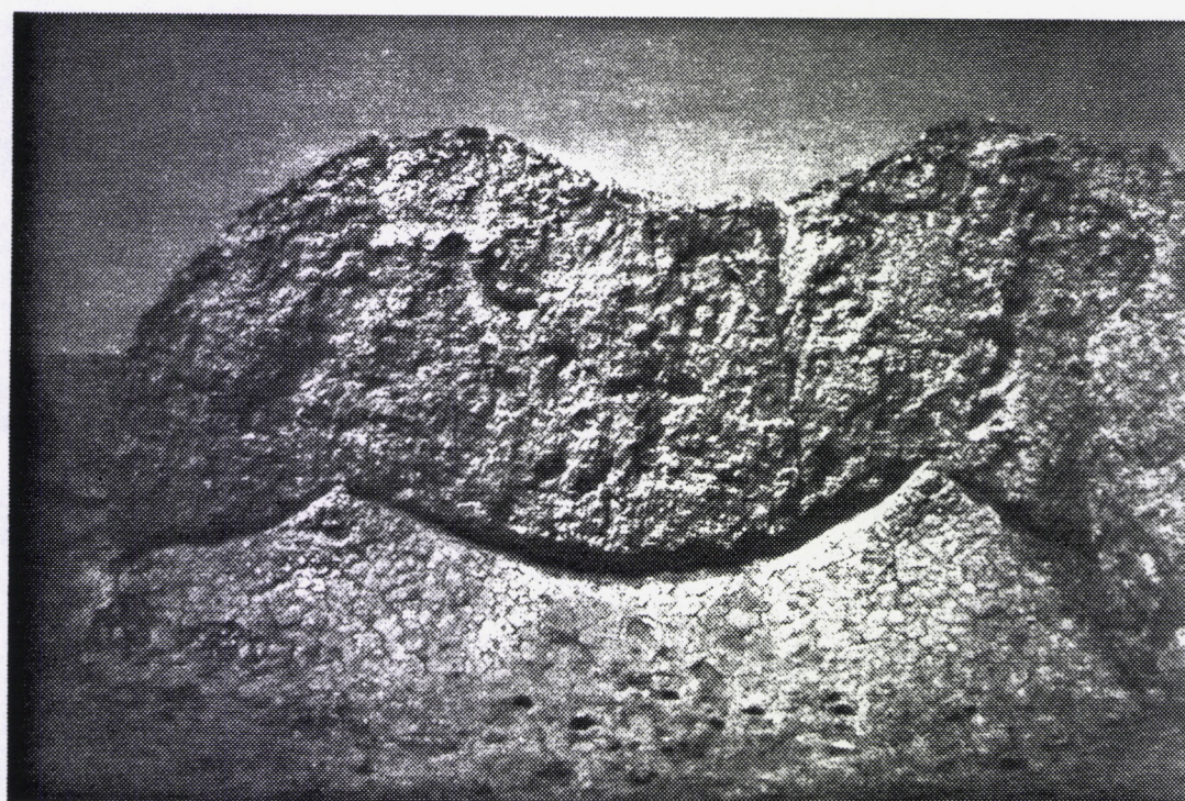
Sillons détritiques en pied de murs.
