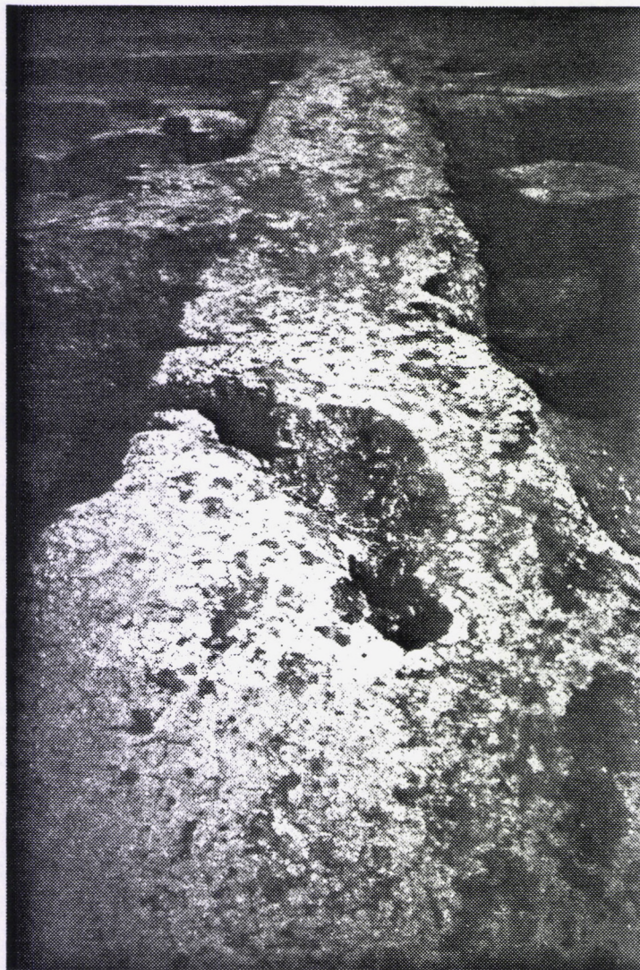
Ravinement en tête de mur.
