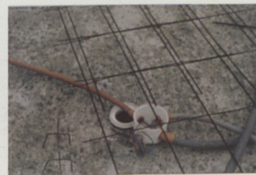
Boîtier électrique intégré à la prédalle
