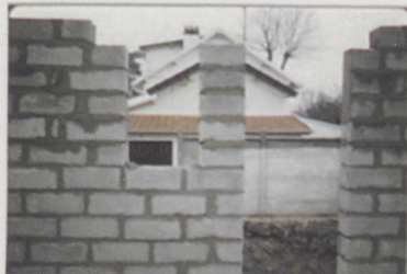
Mauvais calepinage des ouvertures
