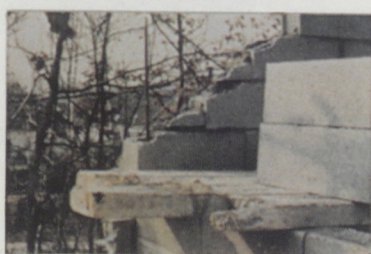
Mauvais calepinage du mur de pignon
