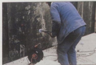
Boîtiers électriques fixés à la banche abîmée par la non répétitivité des trous
