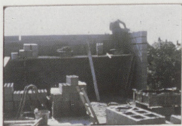
Échafaudage improvisé et dangereux
