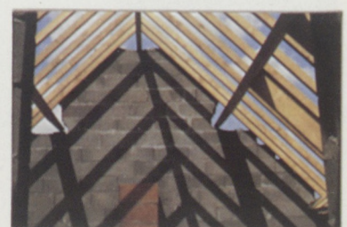
Réservations des pannes mal exécutées
