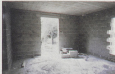
Mauvais calepinage vertical des murs - blocs du premier rang posés à plat -
