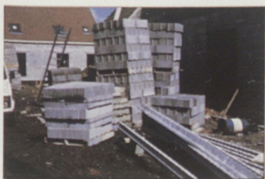
Mauvais stockage des matériaux au sol
