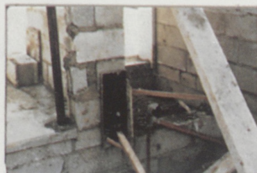
Ouvrage critique: porche - mal calepiné
