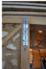
(d) HTI 300%: Filling–Location 7: South transv.wall
