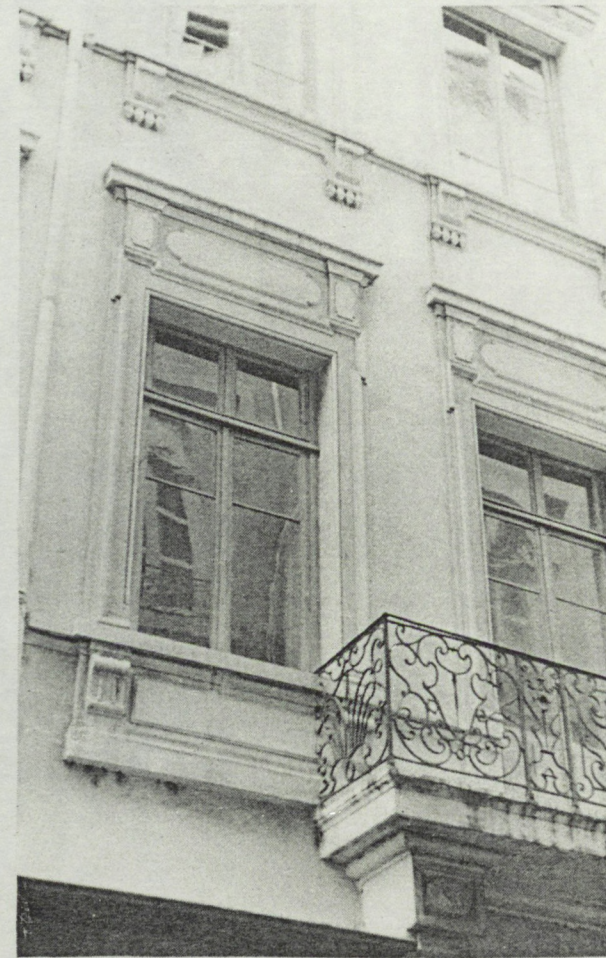
Fig. 45 Remise au gout du jour au XIX e me siècle de la façade d'un immeuble XVIII e ème : enduit à relief (10, rue Bellecordière).
