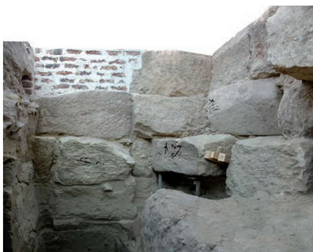
Fig. 21. Emplacement des marques dans les fondations du mur de clôture sud du môle sud du VI e pylône : dipinti n os 20, 21 et 22 (couleurs renforcées). © CNRS-CFEETK.
