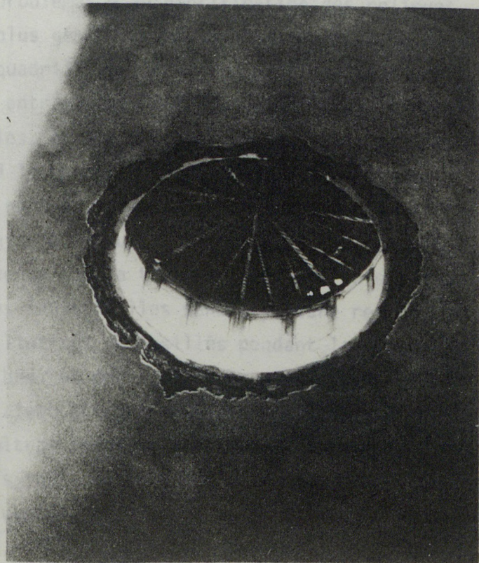
Monument à Cadoudal: le lanternon et la coupole zébrés de lézardes.
