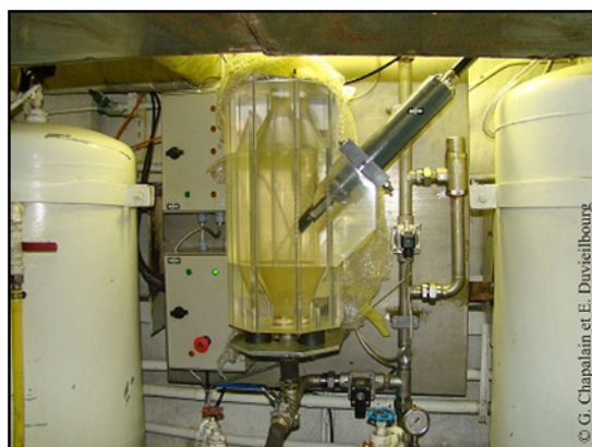
Figure 2. Dispositif SIRANO dans la salle des machines du navire "Enez Eussa III".
