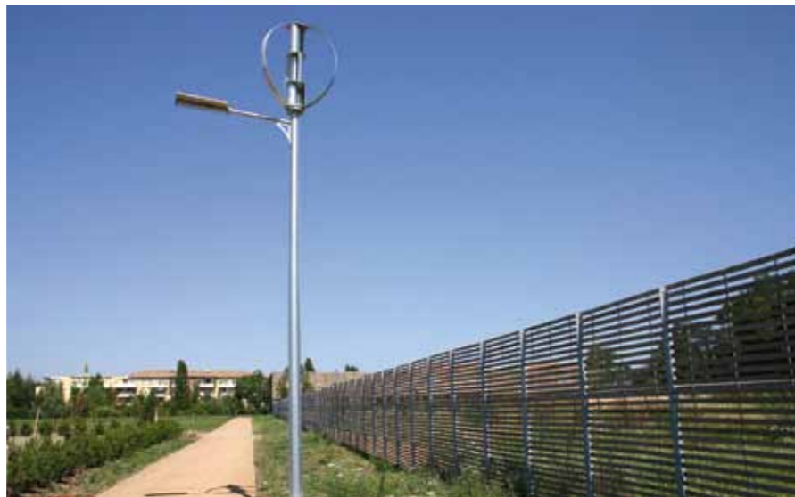
Toulouse, luminaria con sistema de aprovechamiento de energía eólica en Borderouge
