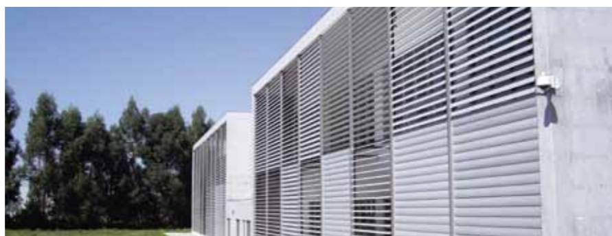
Vila Nova de Gaia, lamas de sombreado en el edificio de viviendas sociales "Vila D'Este" (arriba) y lamas de sombreado regulables en el edificio de servicios "InovaGaia" (abajo).
