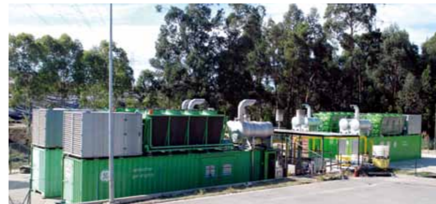
Vila Nova de Gaia. Aprovechamiento de biogás procedente de vertedero en la producción de energía eléctrica y térmica en las instalaciones de Suldouro
