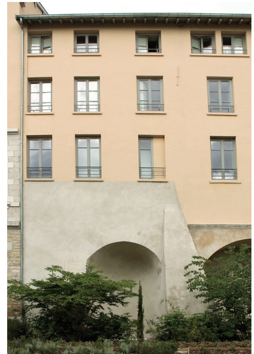
Fig. 5. Vue de l'arcade n° 1 et du contrefort d'angle de la maison de Pierre Sala (E. Bernot, É. Bertrand).
