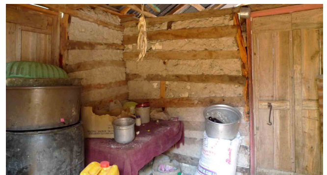
Planches de bois clouées aux poteaux, pour empêcher l'effondrement des panneaux de remplissage des murs vers l'intérieur de la maison, en cas de catastrophe.
