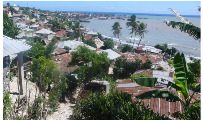
Ville de Jérémie, en bord de mer : toitures en tôle présentant des graves problèmes de dégradation- rouille.
