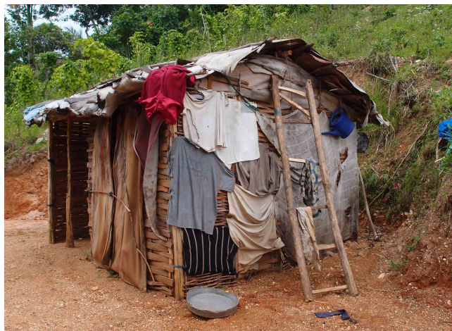
Maison précaire, construite à partir de matériaux locaux et de récupération. Mauvais choix du site d'implantation (contre la colline), risque d'éboulement et de dégâts en cas de fortes pluies.
