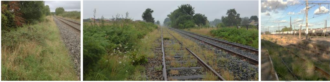
Figure 1 : photos de la présence de végétation sur et aux abords des voies – mise en évidence de facteurs aggravants comme le manque de ballast
