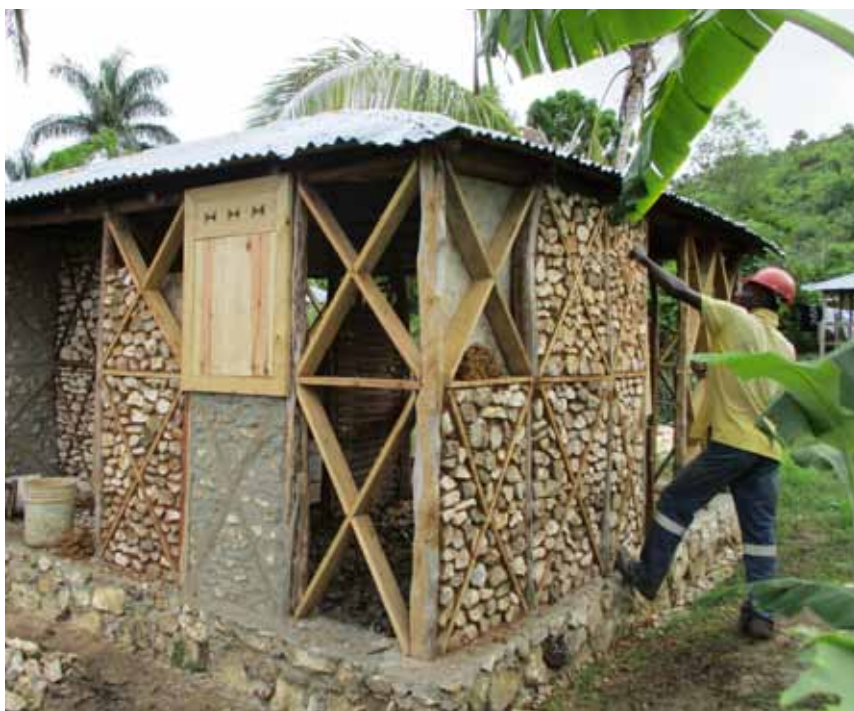
Près de 300 chantiers de réparation ont eu lieu dans la région de Grand Anse dans le cadre du projet coordonné par la Croix Rouge Suisse. Les panneaux de remplissage sont en pierres maçonnées au mortier terre, avec jointoyage au ciment. © Croix Rouge Suisse
