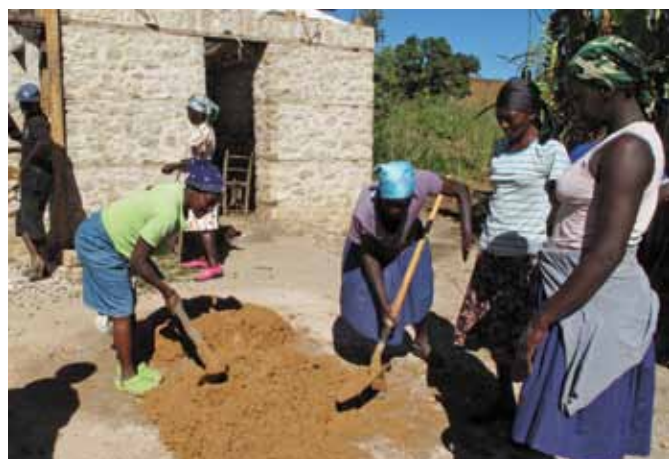
Les familles organisées en kombit construisent ensemble leurs maisons à l'aide d'un ou deux boss. La maison construite est en maçonnerie de pierres porteuse avec insertions bois, en continuité de la culture constructive locale.
