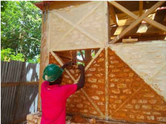
Artisan membre d'Atprocom sur le chantier de l'école de Grand-Boulage en 2014. © Entrepreneurs du Monde
