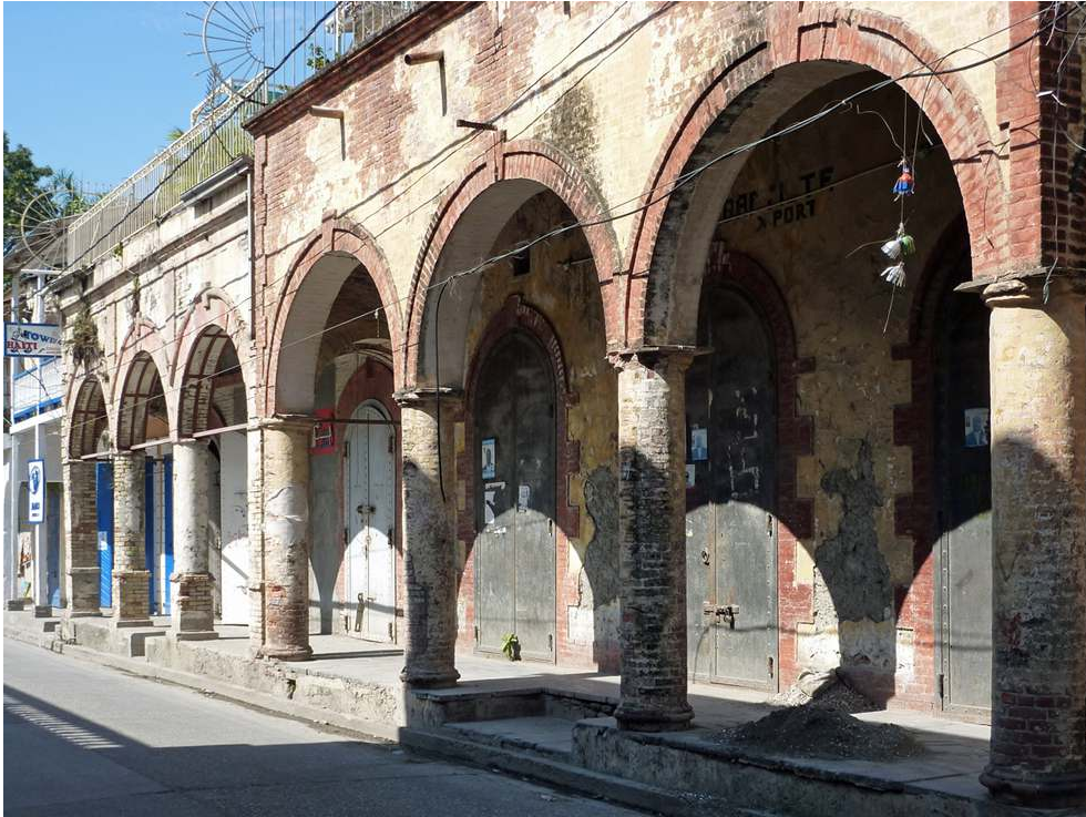
Deux entrepôts ayant appartenu à Léon Baptiste, rue du Commerce (HAJAC0051 et 0052). © ISPAN, 2013.
