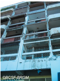
Fig. IV-86. Exemple de bâtiment manquant d'entretien et présentant une forte vulnérabilité.
