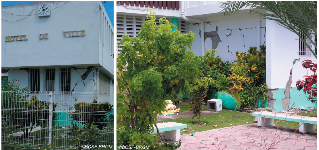
Fig. IV-19. Dommages de niveau 3-4 sur la mairie (vulnérabilité B-C). Le bâtiment a été rasé.
