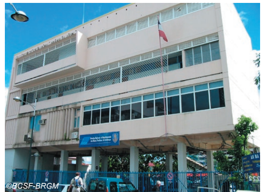
Fig. IV-88. Bâtiment du DRAM sur étage transparent de grande vulnérabilité marqué par une fissuration interne importante (non accessible lors de notre visite).
