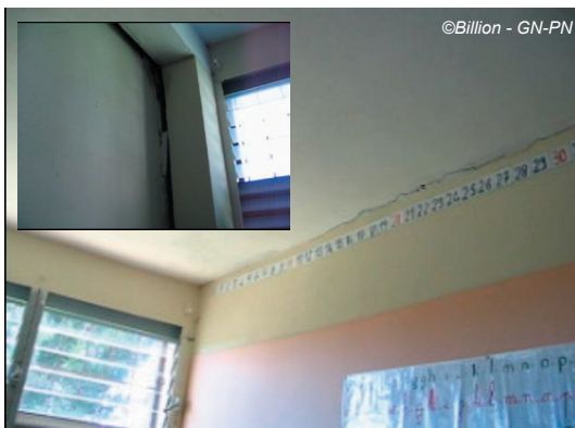
Fig. IV-82. Pointe-Noire, école T. Berbain, décollement du mur de remplissage de la structure poteau-poutre et fissures au raccord mur-dalle constituant des dégâts de niveau 2)
