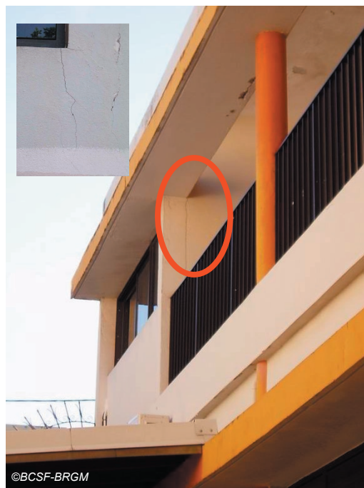
Fig. IV-92. Mairie : dommages légers sur un bâtiment rajouté en 1972 (dommage de niveau 2 ponctuel).
