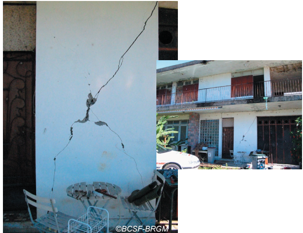
Fig. IV-47. Secteur de Matouba - maison individuelle particulièrement rongée par la corrosion (nombreuses traces d'infiltrations), dégâts de niveau 3, vulnérabilité B.
