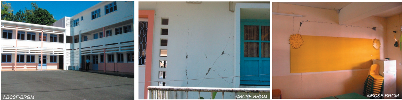
Fig. IV-46. Ecole mixte Louis Chalcol - Entreochoquement des corps de bâtiment disposés en L, dégâts de niveau 2 et 3 - vulnérabilité C).
