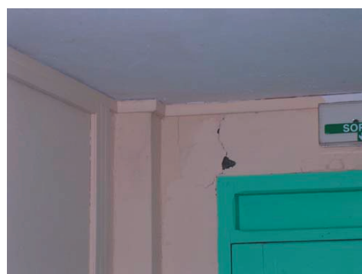
Fig. IV-68. Petit-Bourg - école mixte II, fissure dans l'encadrement d'une porte.
