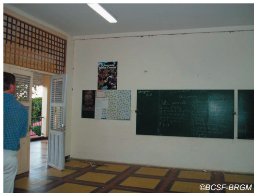
Fig. IV-35. Ecole de Routhiers: les cloisons internes construites pour subdiviser une grande salle au 1 er étage ont toutes été désolidarisées de la structure en béton armé du bâtiment (dommage de niveau 2).
