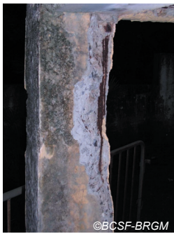
Fig. IV-95. Seul dommage qui nous a été montré sur la commune de Goyave. Il s'agit de l'éclatement du béton d'un poteau de l'école de Christophe, bâtiment ancien et dans un mauvais état de conservation.
