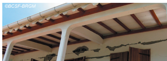
Fig. IV-29. Maison individuelle en maçonnerie de parpaing : fissuration horizontale de degré 3.
