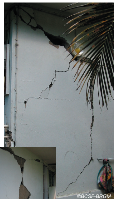
Fig. IV-30. Maison individuelle - nombreuses fissures diagonales de degré 4 sur murs porteurs.
