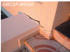
Fig. IV-37. Fissuration sur le pilier gauche à l'entrée de l'église.
