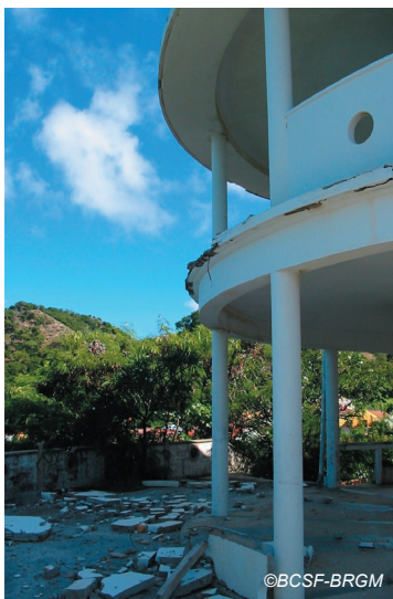
Fig. IV-27. Maison individuelle (centre de Terre-de-Haut) en béton (armé ?) sur pilier sans contreventement (particulièrement vulnérable) : dégâts structuraux et non structuraux graves.
