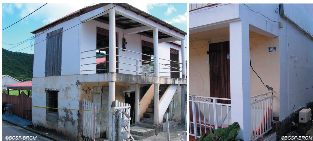
Fig. IV-21. Dommages divers sur maisons individuelles au centre du Bourg de Petites-Anses (vulnérabilité A-B).
