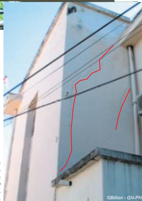
Fig. IV-83. Pointe-Noire façade N-O de l'annexe de la mairie, fissures verticales suite à l'oscillation du bâtiment (dégâts structuraux légers de niveau 2)
