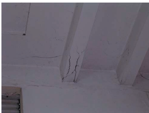
Fig. IV-69. Petit-Bourg - église, fissure sur structure
