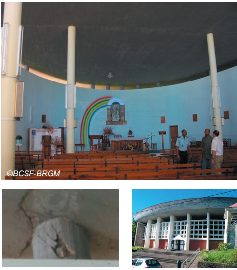
Fig. IV-45. Flambage de piliers sur l'église de Matouba (effets poteaux-courts).
