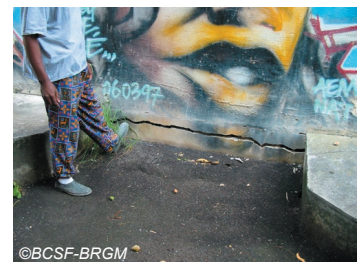
Fig. IV-90. Fissuration large en bout de bâtiment sur les structures porteuses - HLM Henri IV.
