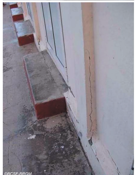
Fig. IV-31. Dommages structurels légers sur l'école de Bananier (niveau 2).
