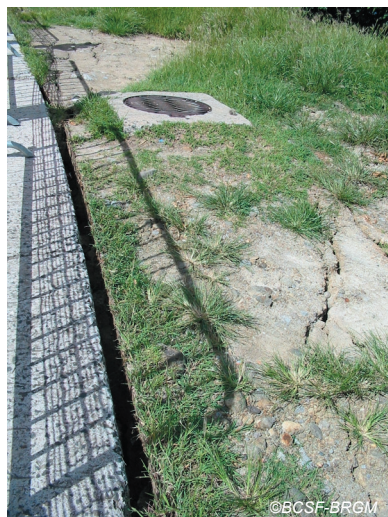
Fig. IV-28. Route du Pain de Sucre : fissuration entre chaussée et bordure.
