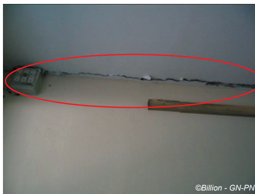
Fig. IV-80. Pointe-Noire - école Acomat, désolidarisation entre le plafond et le mur.
