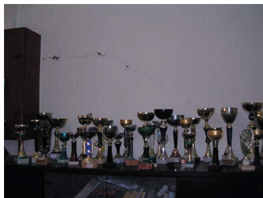
Fig. IV-67. Petit-Bourg - fissure sur un mur non porteur. Sur l'ensemble des coupes, seules 3-4 ont été renversées par le séisme.
