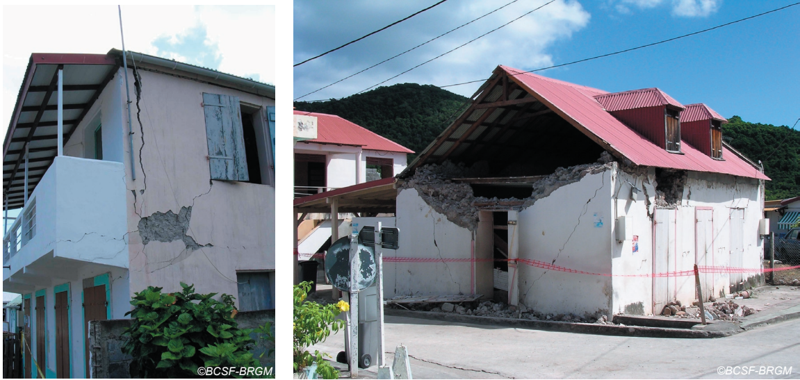
Fig. IV-20. Dommages de niveau 3-4 sur maisons individuelles (vulnérabilité A) au centre du bourg de Petite-Anses.
