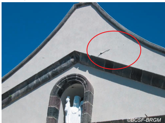
Fig. IV-42. Eglise paroissiale de Saint-Claude (XIX e s.) dommage de niveau 2 / vulnérabilité A.
