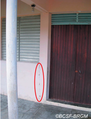
Fig. IV-11. Fissures sur une maison à proximité du débarcadère (vulnérabilité C).
