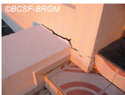
Fig. IV-37. Fissuration sur le pilier gauche à l'entrée de l'église.
