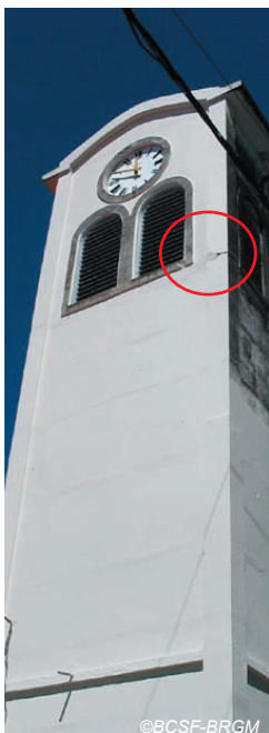
Fig. IV-41. Cisaillement du clocher sous les baies (vuln. C).
