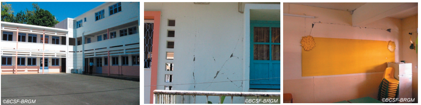
Fig. IV-46. Ecole mixte Louis Chalcol - Entrechoquement des corps de bâtiment disposés en L, dégâts de niveau 2 et 3 - vulnérabilité C).
