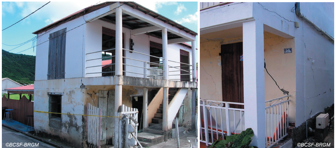
Fig. IV-21. Dommages divers sur maisons individuelles au centre du Bourg de Petites-Anses (vulnérabilité A-B).
