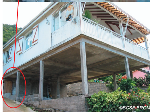
Fig. IV-3 Exemple d'une construction vulnérable implantée sur un terrain en pente et comportant un niveau transparent - Terre-de-Haut.
