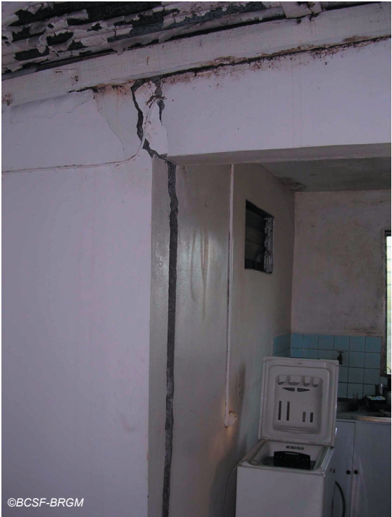
Fig. IV-52. Désolidarisation d'un mur, dommages de niveau 3 et 4 sur une maison en bord de ravine.
