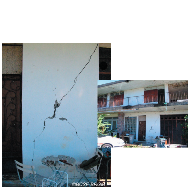
Fig. IV-47. Secteur de Matouba - maison individuelle particulièrement rongée par la corrosion (nombreuses traces d'infiltrations), dégâts de niveau 3, vulnérabilité B.
