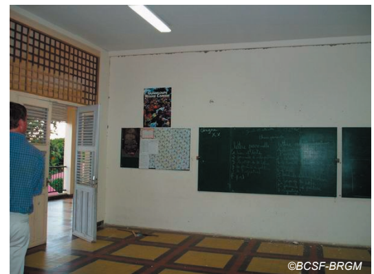
Fig. IV-35. Ecole de Routhiers: les cloisons internes construites pour subdiviser une grande salle au 1 er étage ont toutes été désolidarisées de la structure en béton armé du bâtiment (dommage de niveau 2).
