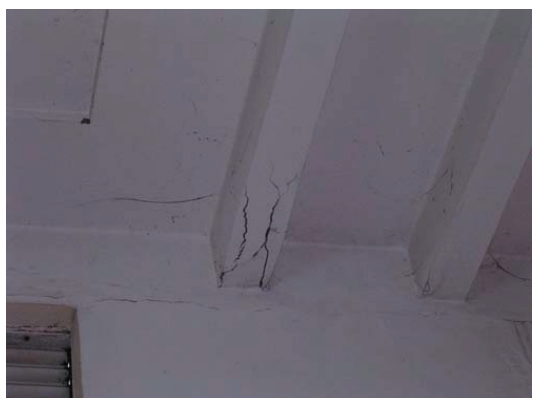
Fig. IV-69. Petit-Bourg - église, fissure sur structure
