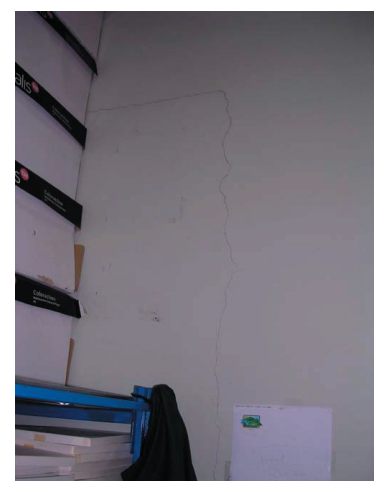
Fig. IV-70. Petit-Bourg - mairie, fissures légères dans la structure non porteuse, salle de reprographie.
