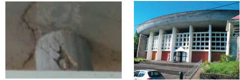
Fig. IV-45. Flambage de piliers sur l'église de Matouba (effets poteaux-courts).
