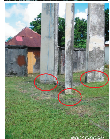
Fig. IV-63. Trépier du clocher de l'église de Saint-Louis - fissuration à la base.
