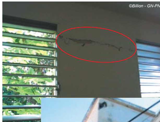
Fig. IV-81. Pointe-Noire - réfectoire de l'école Acomat, nombreuses fissures horizontales (dégâts structuraux légers de niveau 2).
