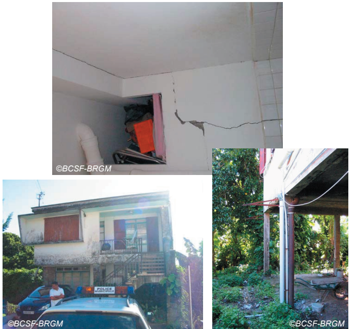
Fig. IV-48. Saint-Claude - maison individuelle sur pilotis, dégâts de niveau 2 et 3, vulnérabilité B.
