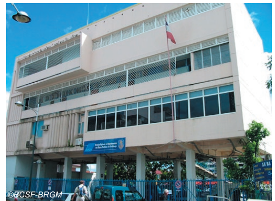
Fig. IV-88. Bâtiment du DRAM sur étage transparent de grande vulnérabilité marqué par une fissuration interne importante (non accessible lors de notre visite).
