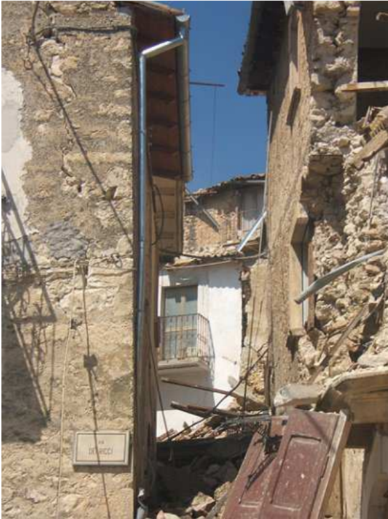
Images relatives aux dommages subis par le centre historique de Poggio Picenze suite au tremblement de terre du 6 avril 2009
