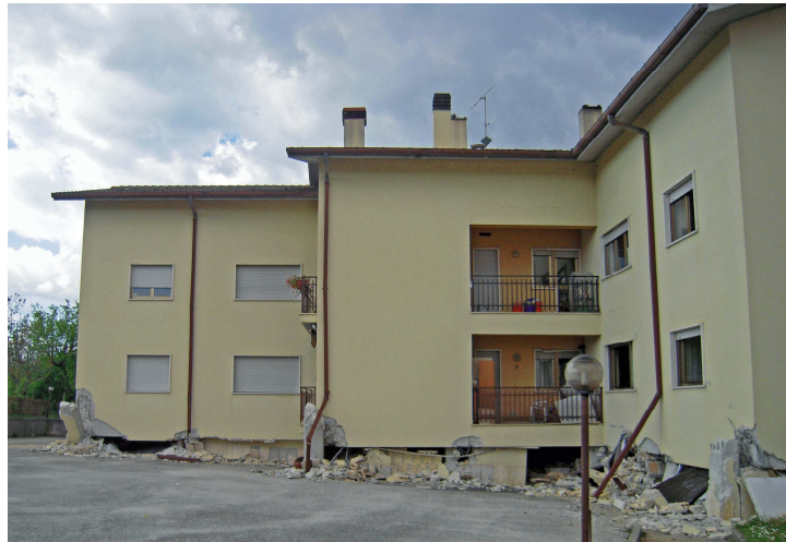
Etage souple. Séisme de L'Aquila (2009). Bâtiment de la rue Dante Alighieri.
