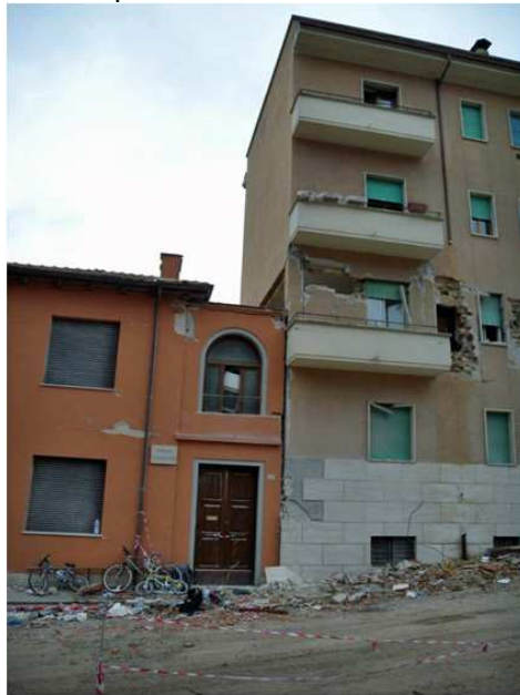
Exemple de martèlement. Séisme de L'Aquila 2009
