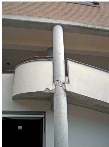
Exemple de colonnes courtes. Séisme de L'Aquila 2009
