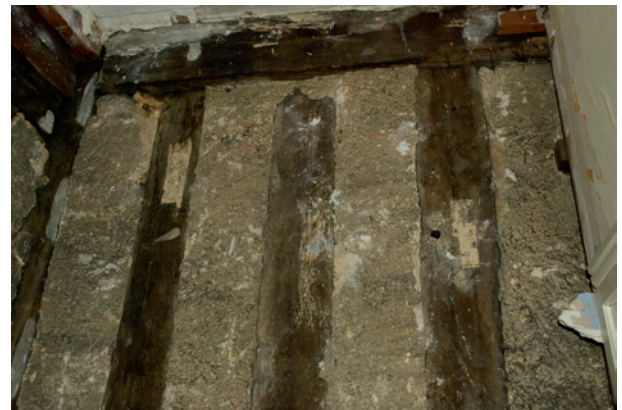
Figure 101 : Le mur nord au deuxième étage – détail de poutres en réemploi dans le colombage à l'est du décrochement (cliché DSC_0394).
