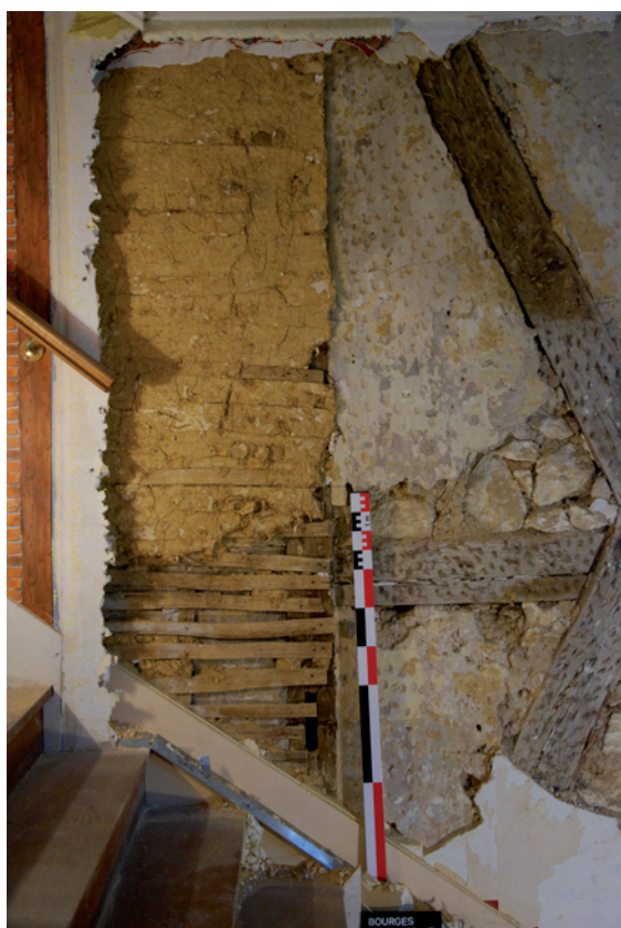
Figure 93 : Le mur nord du premier étage – vue rapprochée de la liaison entre les deuxième et troisième travées des pans de bois (éch. 1 m). A gauche de la mire, on observe une limite nette de l'enduit de torchis sur lattis de châtaignier. A droite de cette limite, le torchis était appliqué directement sur les enduits antérieurs, sans lattis (cliché DSC_02306).
