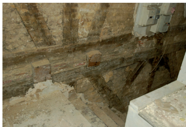
Figure 59 : Vue générale des solives sciées pour le passage de l'escalier actuel le long du mur nord (cliché DSC_0372.JPG).
