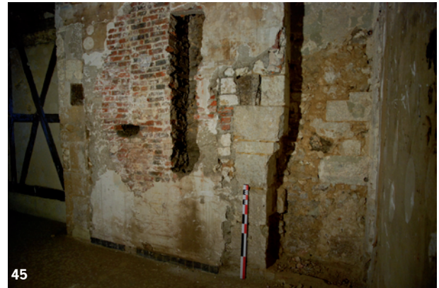
Figure 47 : Détail de la poutre de la hotte du piédroit droit de la cheminée. A l'origine, elle était saillante et portait la hotte de la cheminée (cliché DSC_0576).
