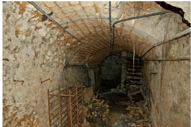
Figure 113 : La cave sud du n° 17 – vue générale du volume prise depuis l'escalier d'accès en regardant vers la rue à l'Est (cliché DSC_0405).
