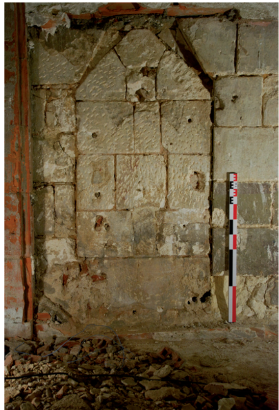
Figure 69 : Vue rapprochée de l'aménagement du puits dans le mur nord (cliché DSC_0589).
