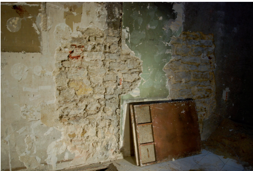
Figure 50 : Détail du parement en petit appareil du mur sud, exposé dans un sondage (cliché DSC_0610).
