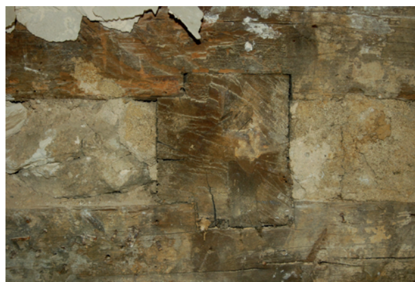
Figure 60 : Le mur nord - détail de l'assemblage d'une solive entre la sablière haute des pans de bois du rez-de-chaussée et la sablière basse de ceux du premier étage (cliché DSC_0375).
