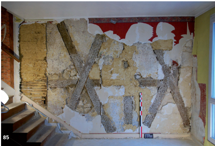
Figure 85 : Le mur nord du premier étage – vue générale des pans de bois en croix de Saint-André de la partie orientale du mur (éch. 1 m). La paroi d'origine est recouverte par une séquence d'enduits (cliché DSC_0299).
