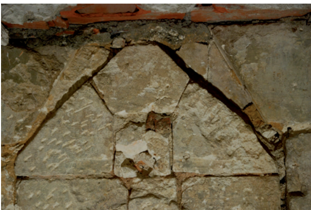
Figure 70 : Détail du montage clavé du sommet du puits et de l'entaille des blocs du parement du mur au-dessus (cliché DSC_0593).
