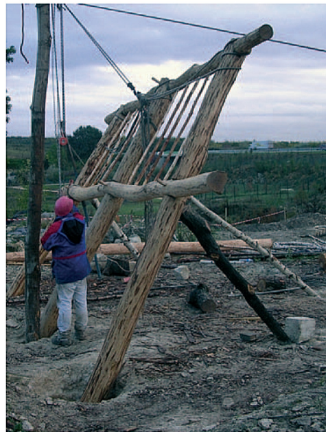
Fig. 22b - Levage du premier pan de bois à l'aide d'un mât haubané.
