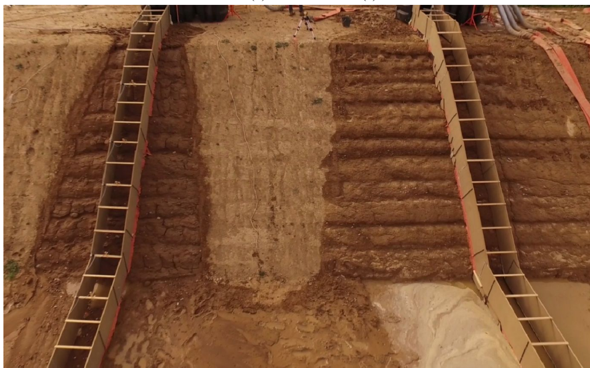
Figure 15 – Vue du sol après la campagne d'essais. Les fuites ont provoqué une érosion du sol de part et d'autre des canaux. Le sol non traité étant plus érodable, les fuites sont plus importantes, et l'érosion de part et d'autre du canal est plus importante, plus localisée et plus profonde (gauche). Au contraire, le sol-chaux est moins érodable, et les écoulements de fuites s'étalent plus largement de part et d'autre du canal (droite). Sur les deux sols, l'érosion de la couche superficielle met en relief les couches de compactage.
