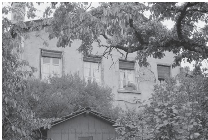
Fig. 4 Façade principale d'une maison individuelle en pisé de terre (visible au niveau du trumeau entre deux fenêtres), 23 rue de Cuire, Lyon (Rhône), 4 e arrondissement, quartier de la Croix-Rousse, 1981. Détruit. Photo : Anne-Sophie Cléménçon
