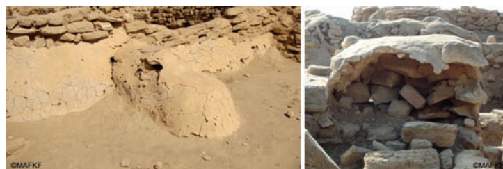
Fig. 4, Méfaits du ciment blanc empêchant l'évaporation de l'humidité, photo : MAFKF
