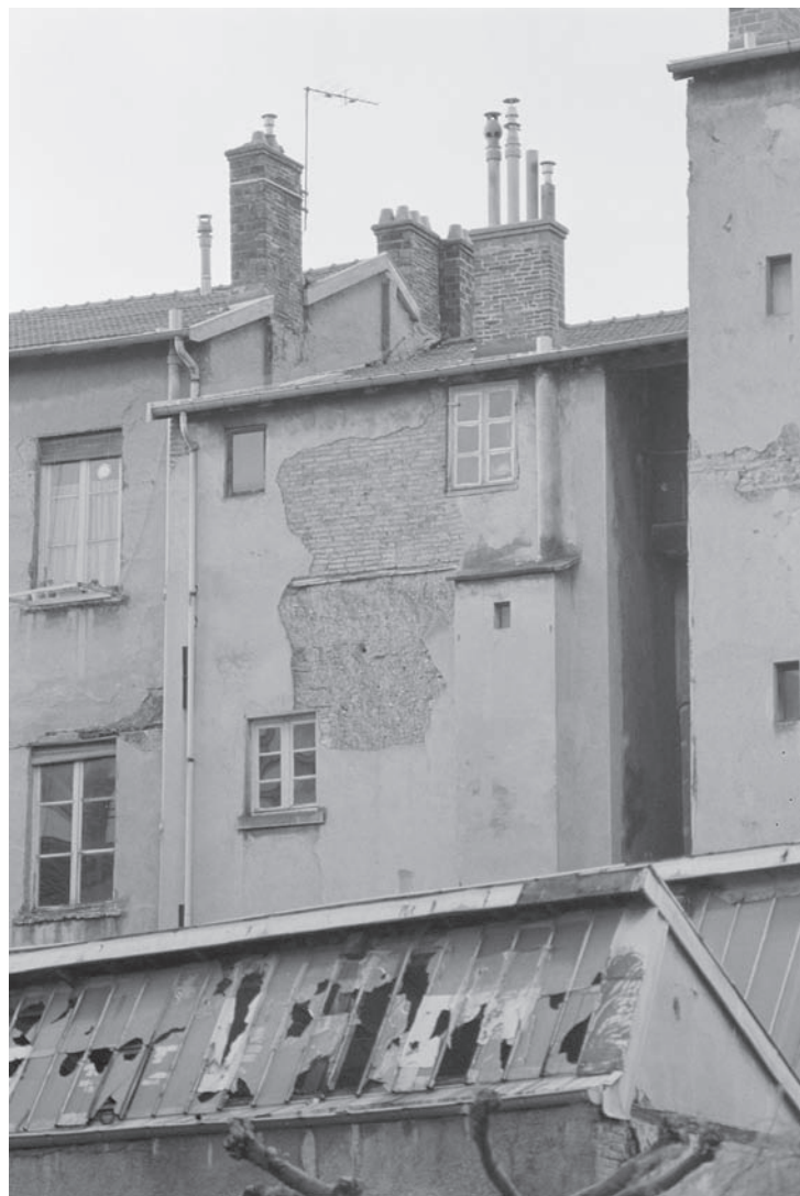
Fig. 3 Façade arrière de l'immeuble en pisé de terre (visible et en briques sur la partie haute), 15 rue de l'Orangerie à Caluire et Cuire (Rhône), 1981. Existe toujours en 2016. A l'avant-plan les verrières des anciens ateliers. Photo : Anne-Sophie Cléménçon
