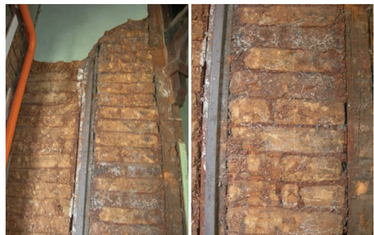
Fig. 7 Detalle pies derechos de madera y bloque de adobillo ensamblado a ellos, fuente: autores
