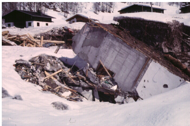
Figure 9 : Mur en béton globalement intègre mais basculé et déplacé faute d'appuis suffisants (défaut de stabilité externe)
