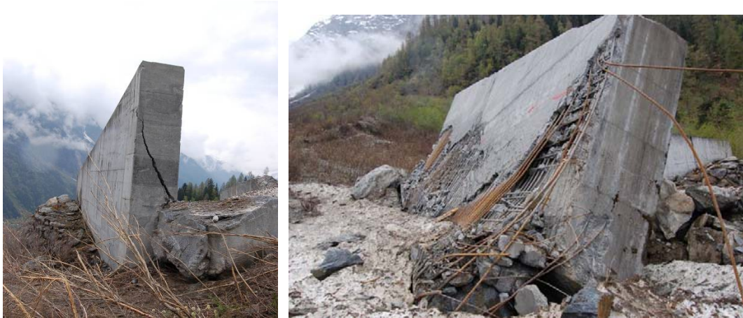
Figure 19 : Destructions dues à l'avalanche du 5 avril 2006
