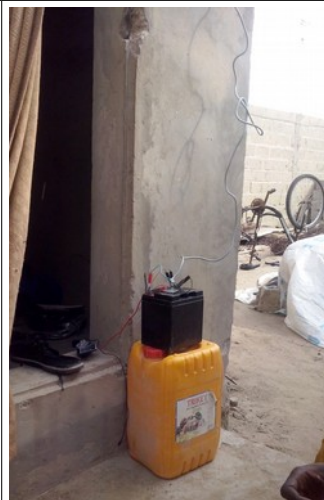
En l'absence de raccordement au réseau électrique, les habitants utilisent des batteries de voiture.
